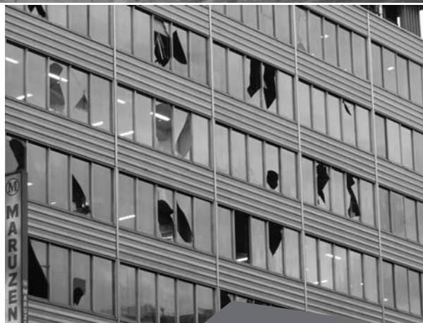
写真4 福岡市天神のビル被害 （窓ガラスの破損、歩道への落下）
